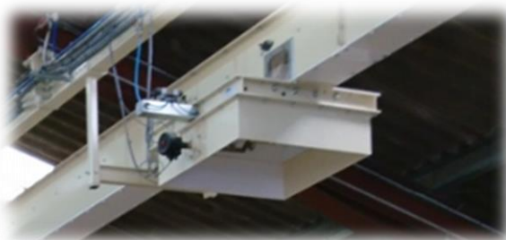
Vannes sous transporteur.
